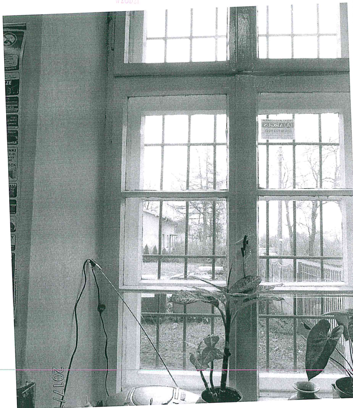
Najlepiej zachowane okna w budynku
